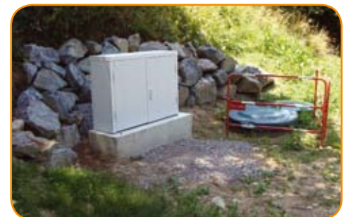
3- Le nouveau poste de relevage des eaux usées.
