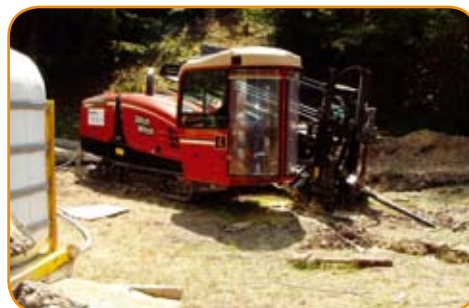
2- Travaux de forage sous Le Cher pour passer la nouvelle conduite de refoulement des eaux usées.
